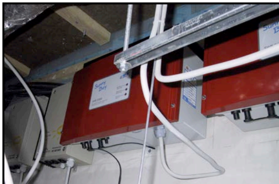
Bild 11 : String-Wechselrichter, Schutzart IP 64, mit selbsttätiger Netzfreischalteinrichtung, Montageort unterhalb des Daches
