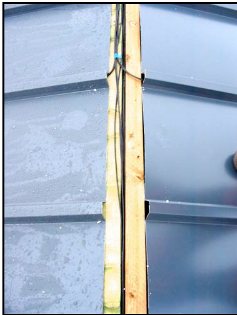
Bild 15: Die DC-Verkabelung wird verdeckt witterungsgeschützt verlegt.
