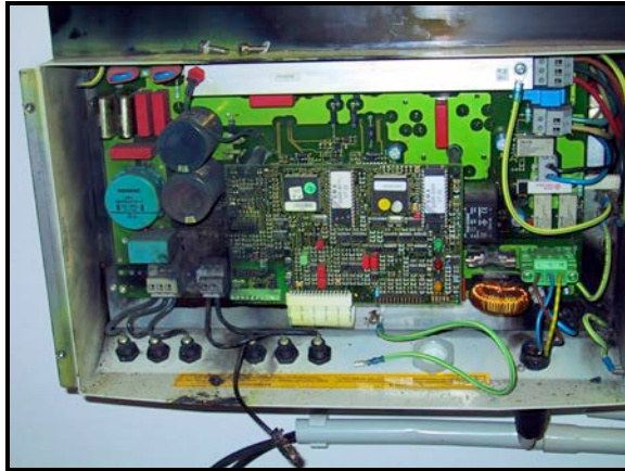
Bild 3: Schäden am Wechselrichter
