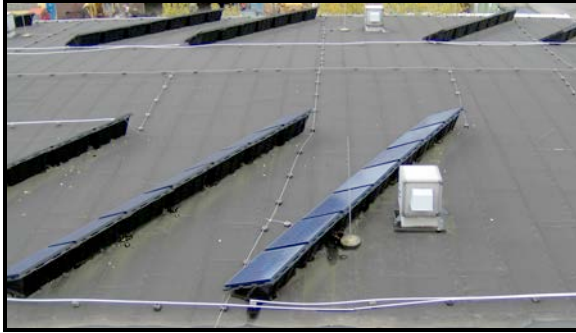
Bild 6: Die Verkabelung der Photovoltaikanlage kreuzt die Fangeinrichtung und verläuft parallel entlang der Fangleitung
