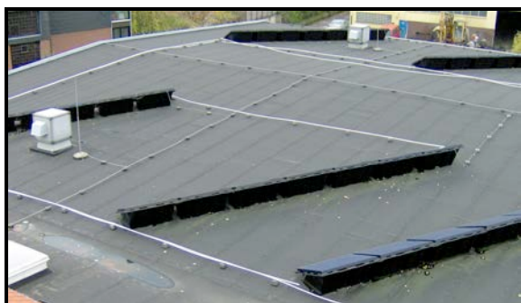
Bild 5: Die Verkabelung der Photovoltaikanlage kreuzt die Fangeinrichtung und verläuft parallel entlang der Fangleitung
